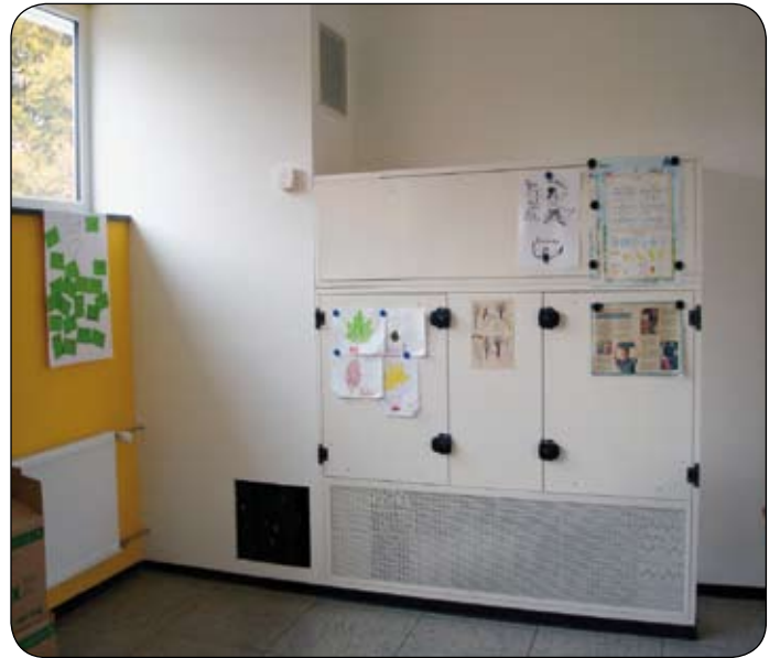
Grundschule Sailauf (Rosenberg Ventilatoren)
